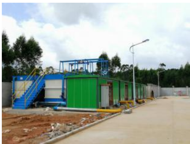
图 3.3-2 园区污水处理厂现状照片
