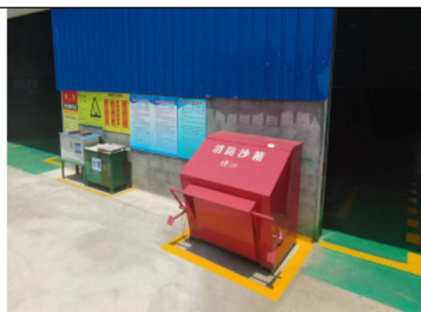
危废间应急消防措施
