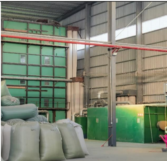
车间布袋除尘设施
