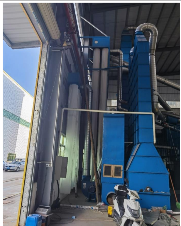
车间布袋除尘设施
