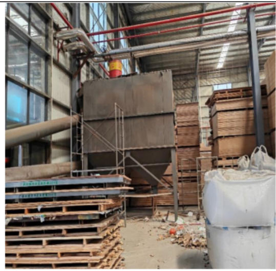
锅炉布袋除尘
